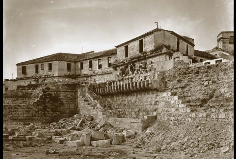
Derribo de la Muralla de Mar, frente al Castillo de La Real Fuerza.
